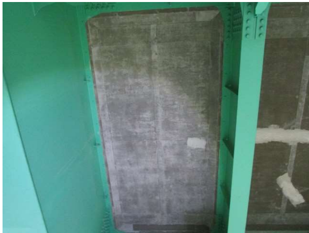
S4 바닥판하면 망상균열(A=2.5×5.0=10.00㎡)
