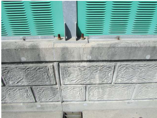
S4 방호벽 균열( C_w=0.2/L=1.0m )
