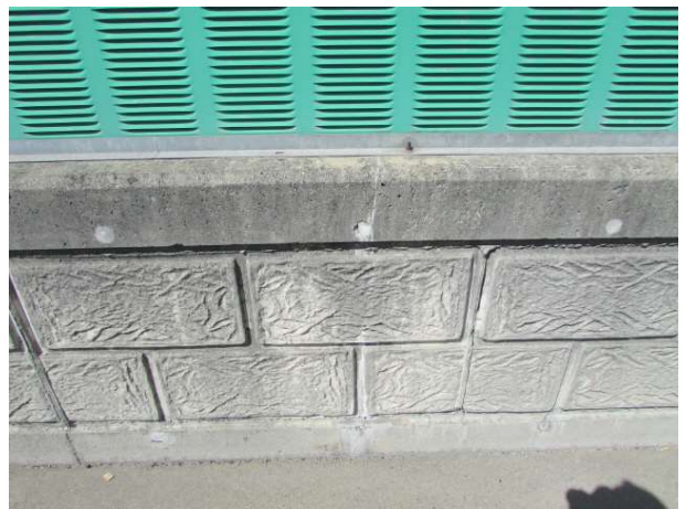
S2 방호벽 균열( C_w=0.2/L=1.0m )
