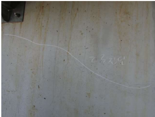
P2 코평 균열( C_w=0.3/L=3.0m )
