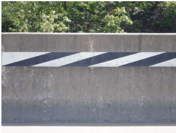
S2 중앙분리대 균열( C_w=0.2/L=1.3m )
