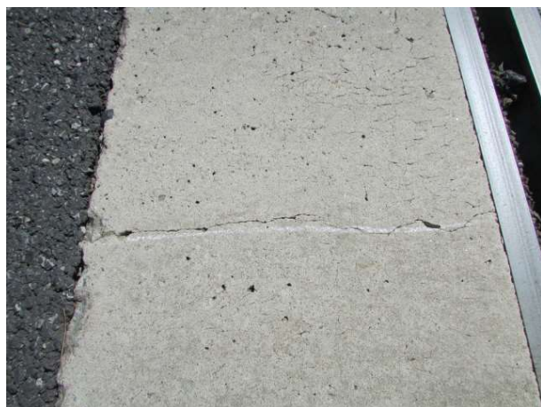
S4 후타재 균열( C_w=0.2/L=0.5m )
