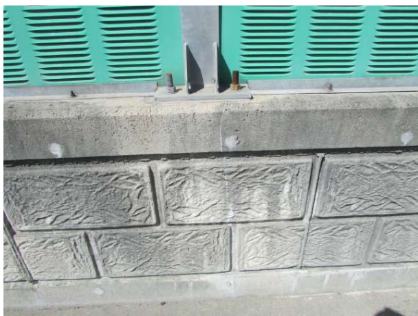
S2 방호벽 균열( C_w=0.2/L=1.0m )
