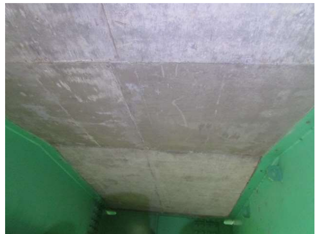
S4 바닥판하면 망상균열(A=2.0×5.0=10.00㎡)
