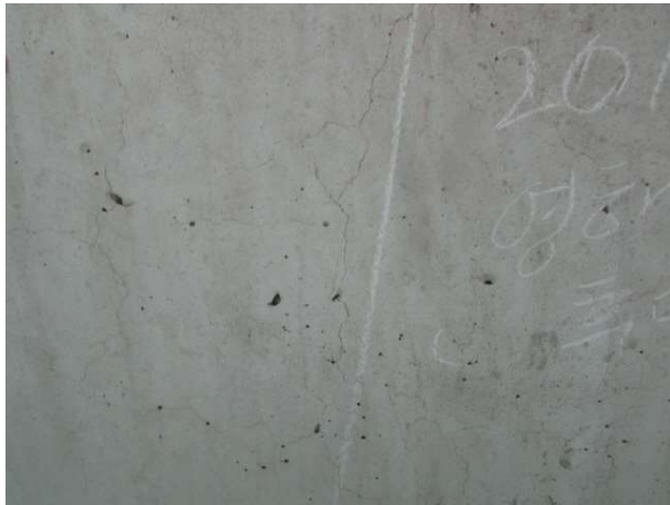
P3 코평 균열( C_w=0.2/L=1.7m )
