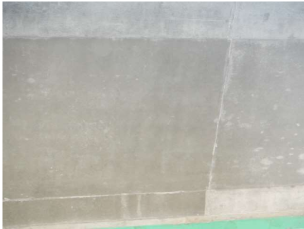
S3 바닥판하면 망상균열(A=2.0×5.0=10.00㎡)
