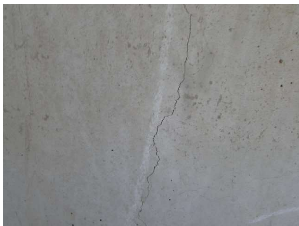
P3 코펑 균열( C_w=0.2/L=1.5m )
