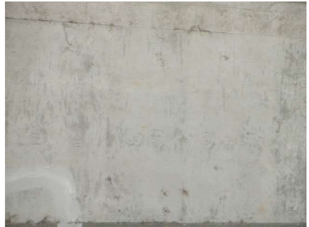
S3 바닥판하면 망상균열(A=2.5×5.0=㎡)
