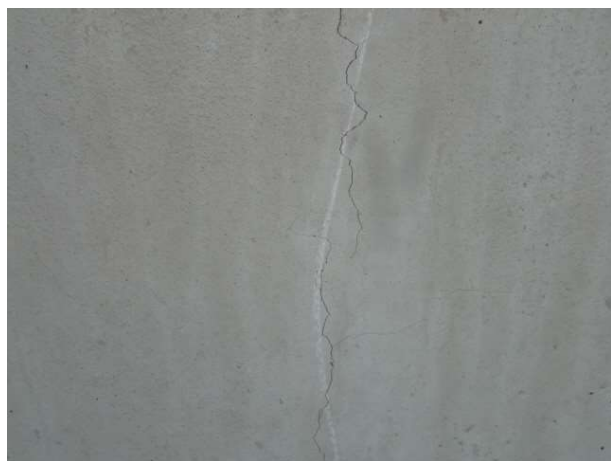
P3 코펑 균열( C_w=0.3/L=1.7m )
