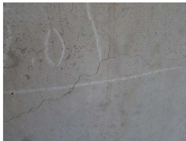
P3 코펑 균열( C_w=0.2/L=1.0m )
