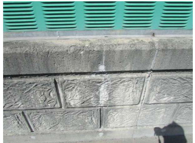
S2 방호벽 균열( C_w=0.2/L=1.0m )
