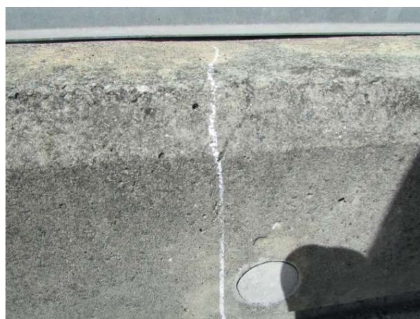
S2 방호벽 균열( C_w=0.1/L=0.7m )
