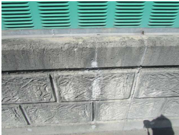
S2 방호벽 균열( C_w=0.2/L=1.0m )
