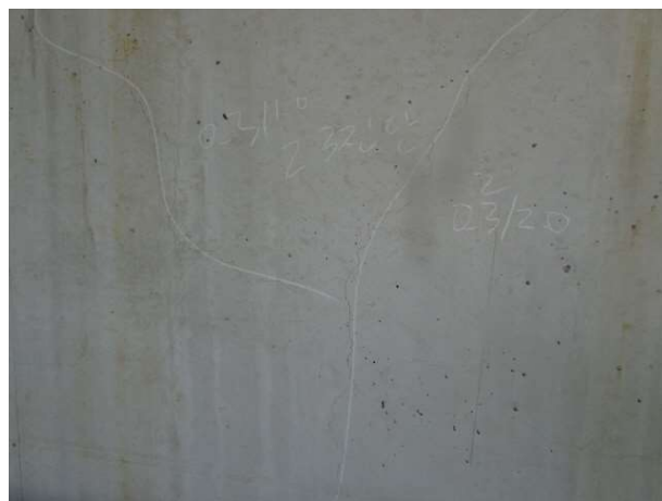
P3 코펑 균열( C_w=0.3/L=1.0m )
