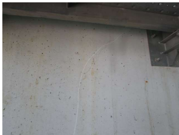
P2 코펑 균열( C_w=0.2/L=1.0m )
