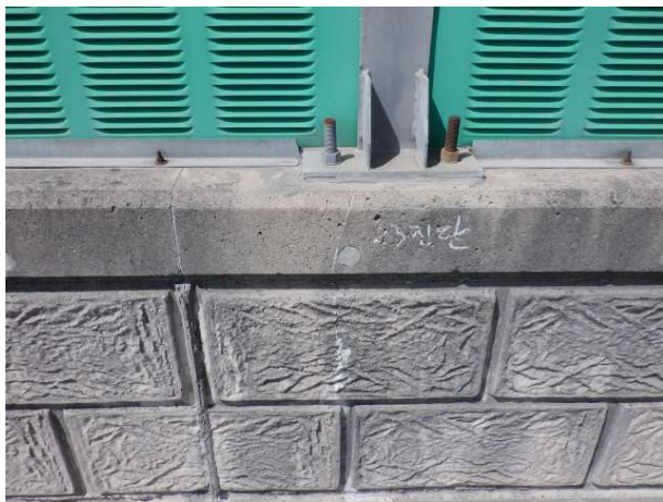
S2 방호벽 균열( C_w=0.1/L=0.7m )
