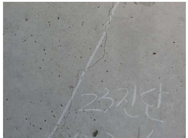
P2 코평 균열( C_w=0.3/L=3.0m )
