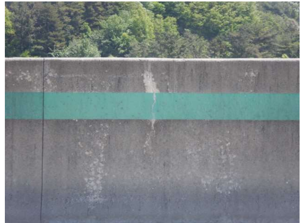
S3 중앙분리대 균열( C_w=0.3/L=1.2m )
