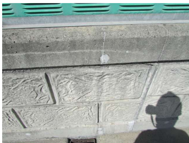
S2 방호벽 균열( C_w=0.1/L=1.0m )
